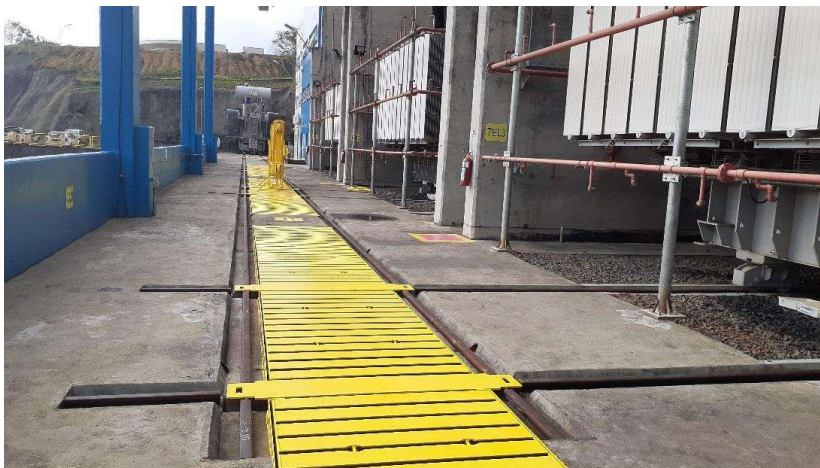
Figura 4 - Vista geral da "baias" e disposição dos trilhos.
