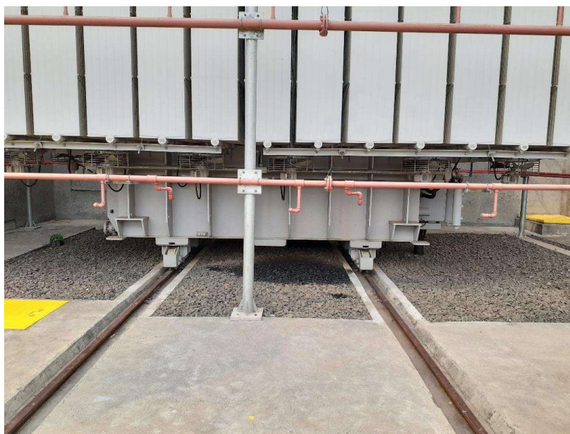
Figura 3 - Vista frontal do transformador na sua "baia" e posição das rodas e trilhos.
