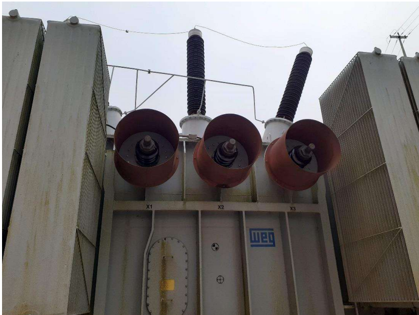
Figura 9 - Detalhe das buchas de BT
