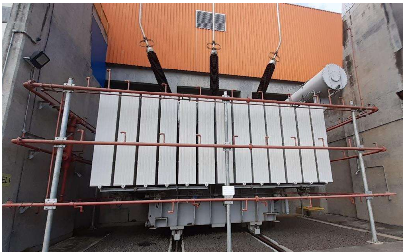
Figura 1 - Vista Frontal do transformador elevador em sua "baia".
