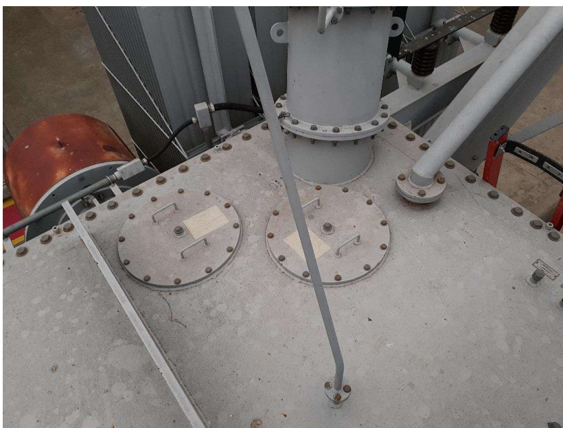
Figura 12- Detalhe das janelas de inspeção na tampa superior e caneco da H0 e tubulação rele 63T
